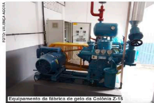
Equipamento da fábrica de gelo da Colônia Z-15
