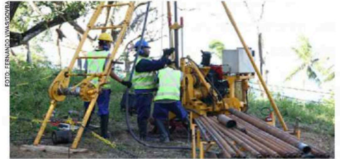
O Sistema Rodoviário Ponte Salvador-Itaparica será um novo vetor de distribuição de renda e vai impulsionar a economia de toda a Bahia
