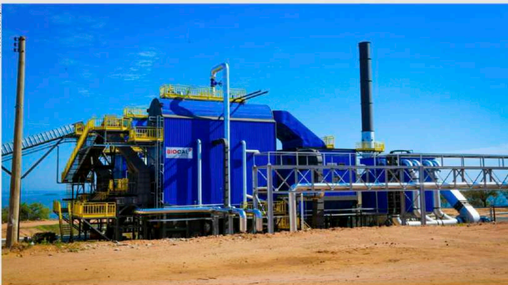
Caldeira de tecnologia de ponta adquirida pela CVI em seu processo de modernização
